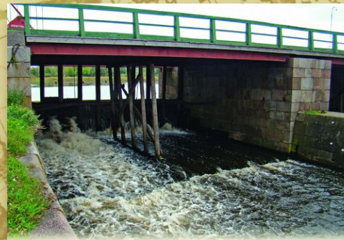
Вышний Волочёк. Бейшлот на Цнинском канале. Бейшлот — водоспуск с подъемными щитами. Водная система, построенная М. И. Сердюковым, работала бесперебойно до конца 19 века.
